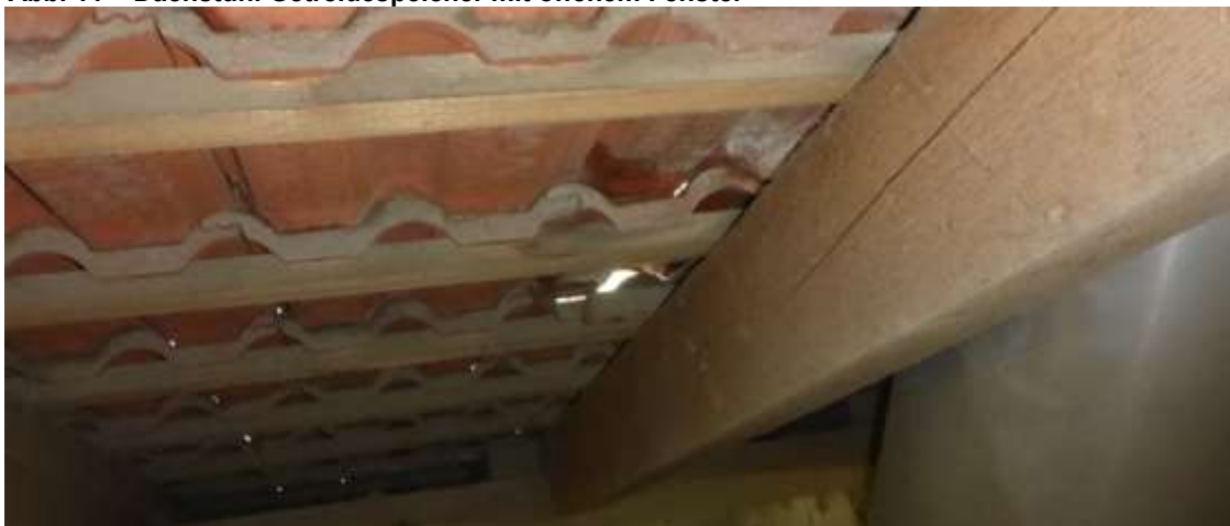
Abb. 12 Dachstuhl Getreidespeicher, Beispiel Spaltenöffnungen im Dach
