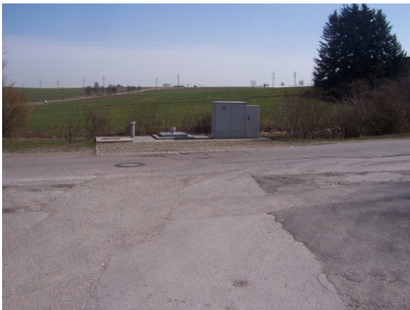
Hebeanlage an der nördlichen Ortseinfahrt
