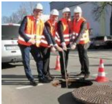
2017 FW Netz Querung A9 Eching
